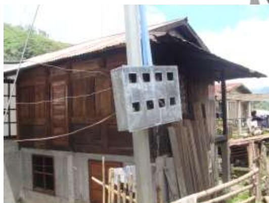
圖 9、S 聚落的電箱，全聚落中共有四個；每根電線桿上約 15-20 條電線
